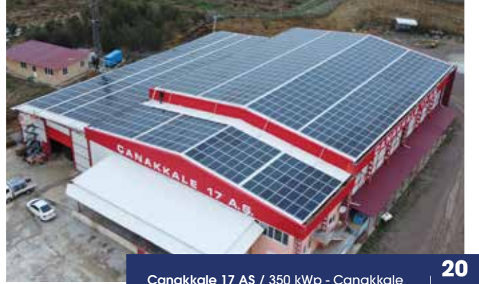
Çanakkale 17 AŞ / 350 kWp - Çanakkale
