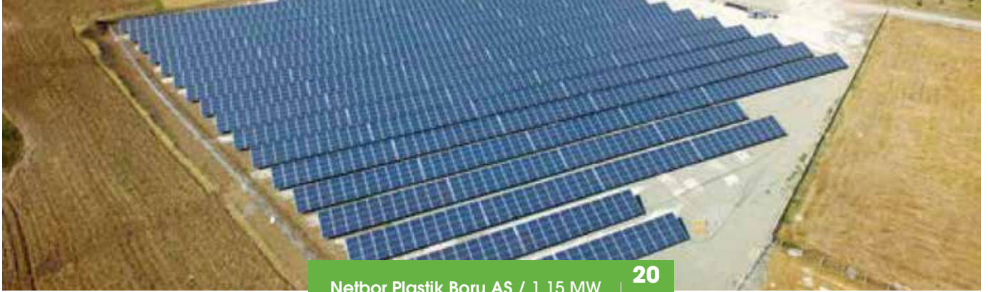
Netbor Plastik Boru AŞ / 1.15 MW
